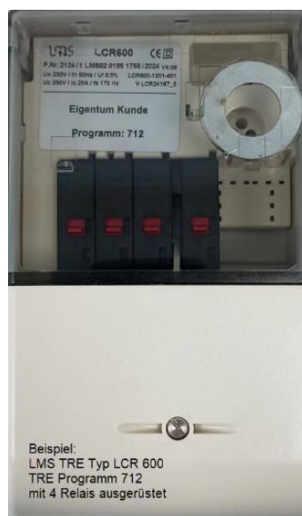
Bild 2: Eingesetztes TRE bei EWE NETZ GmbH
