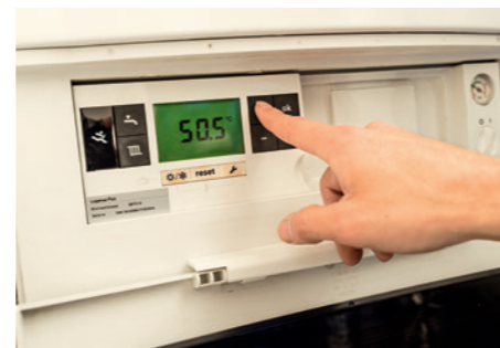
Selbstadaptierende Gasgeräte (SCOT-Regelung usw.)
